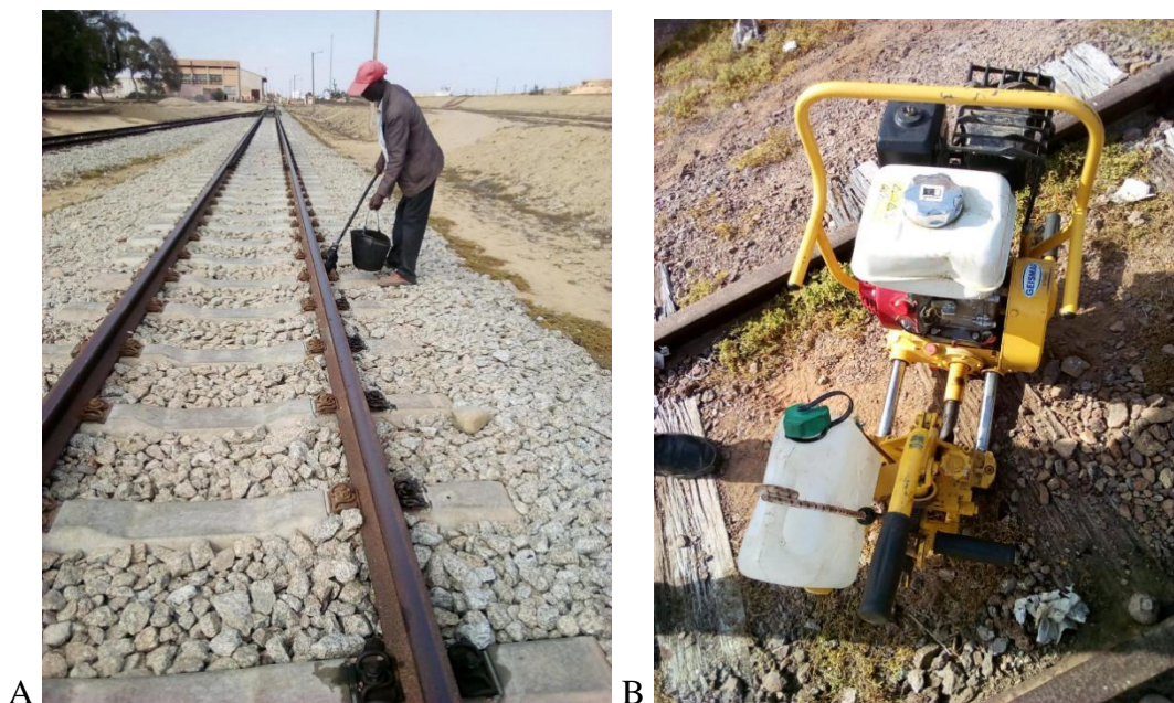
Figura 25. Actividades de manutenção da via-férrea desenvolvidas por técnicos da DIF. Imagem A: Lubrificação da via. Imagem B: Equipamento de furar carril.
