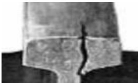
Figura 13. Fenda longitudinal vertical.
