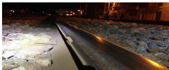
Figura 8. Deformação da face interna do carril devido a esmagamento
